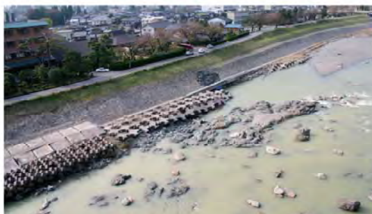
堤防護岸の決壊及び根固め流失(砺波市 庄川町金屋地先)
