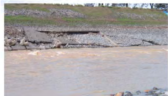
堤防護岸の決壊及び根固め流失(砺波市 庄川町青島地先)
