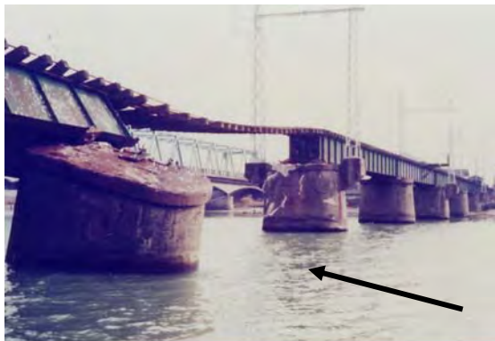
加越能鉄道落橋
