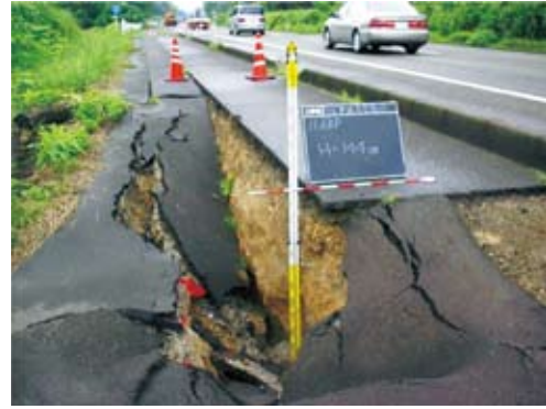
写真2-2-10 歩道沈下(柏崎市西山町田沢)
