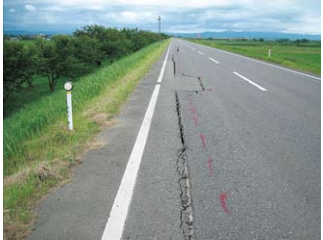
写真2-1-2 地震直後、堤防上面の亀裂
