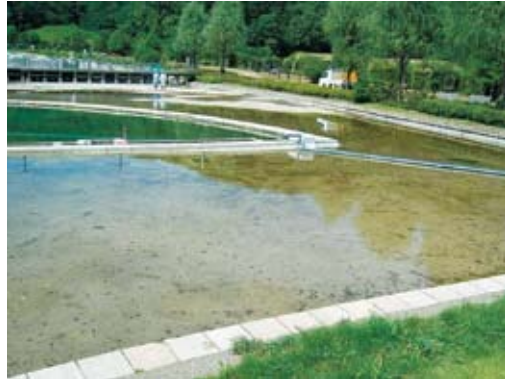
写真2-3-6 越の池(漏水発生)
