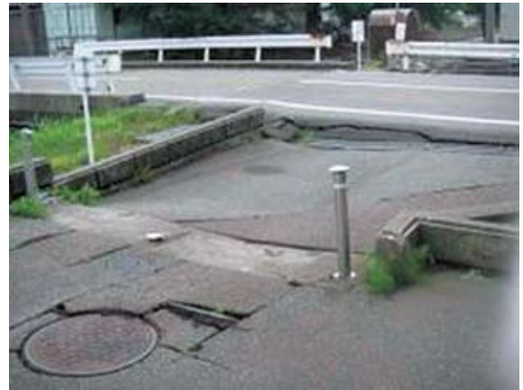
写真2-4-2 舗装のひび割れ・陥没
