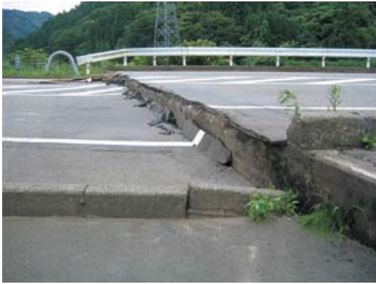
写真2-2-29 被災状況(藤掛川橋)
