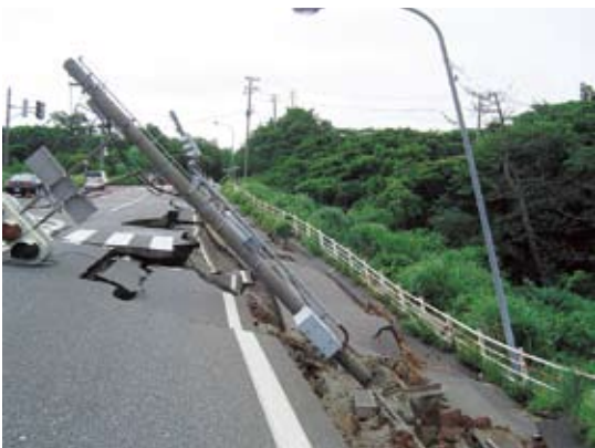
写真2-2-27 被災状況(柏崎市鯨波)
