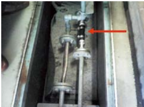
写真2-5-5 発電発電装置 給油管の可とう部を耐油性ホースで仮補修
