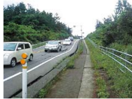
写真2-2-8 路肩亀裂(上越市柿崎区柿崎)
