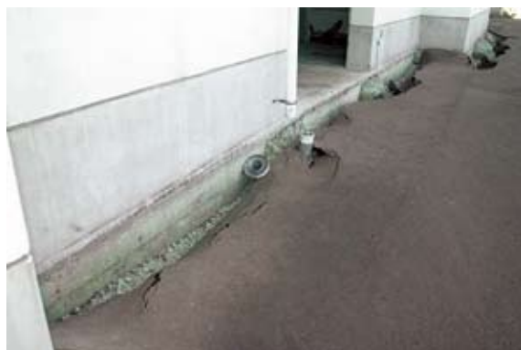
写真2-3-23 新潟県営半田住宅(公営)舗装の沈下により埋設配管に被害
