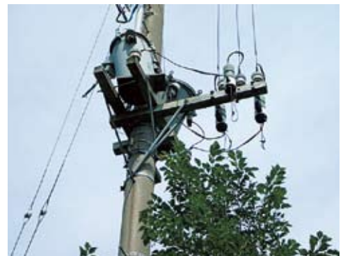
写真2-5-7 柱上トランスの傾き
