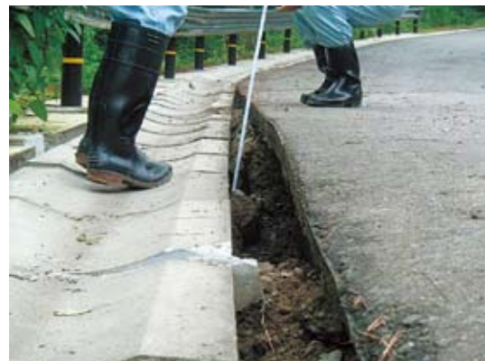
写真2-3-4 健康ゾーン幹線園路 (側溝・防護柵にずれ)
