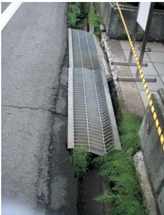
写真2-4-3 排水溝の破損
