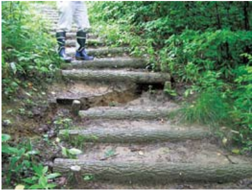
写真2-3-7 自然探勝路(亀裂)
