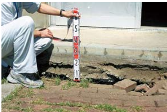
写真2-3-22 新潟県営栄町住宅(公営)外構玄関前舗装沈下状況
