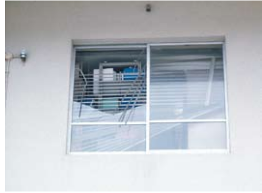
写真2-6-2 柏崎維持出張所窓ガラスの破損
