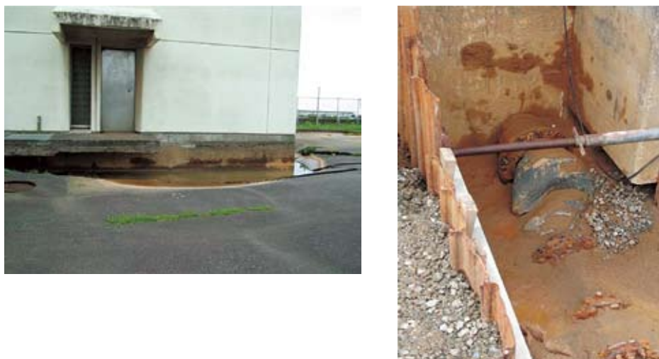
写真2-3-19 八坂中継ポンプ場の被災状況
