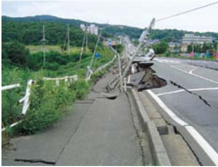
写真2-2-7 路肩・歩道崩壊(柏崎市鯨波)
