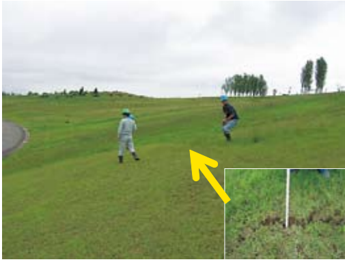
写真2-3-5 フォリーの丘(亀裂(約11m))
