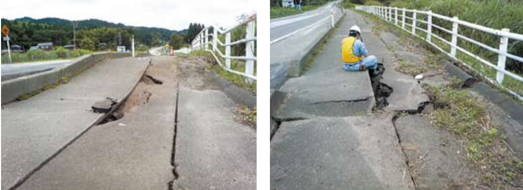
写真2-5-13 国道116号被災状況(隆起・陥没により、歩道部分の光ファイバケーブル埋設管路が被災)
