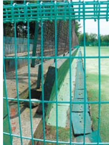
写真2-3-12 白竜公園 (コンクリート擁壁の破損)
