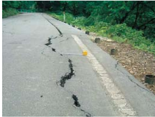
写真2-3-8 野生ゾーン幹線園路 (路面にクラック(2箇所 90m))
