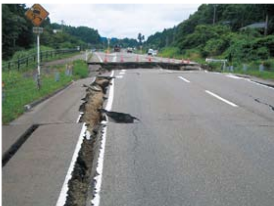
写真2-2-33 被災状況(柏崎市西山町尾野内)
