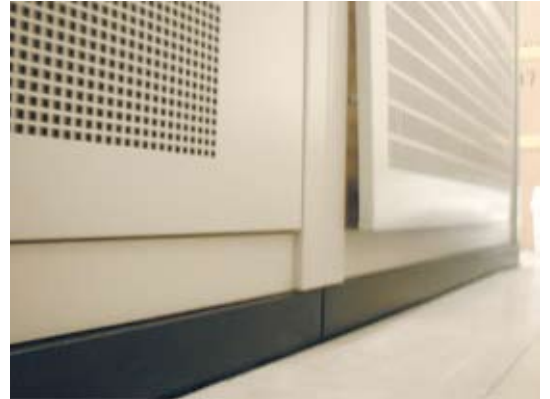
写真2-5-2 レーダ送受信装置の背面扉外れ
