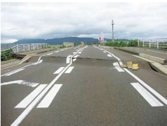
写真2-2-25 被災状況(比角跨線橋)
