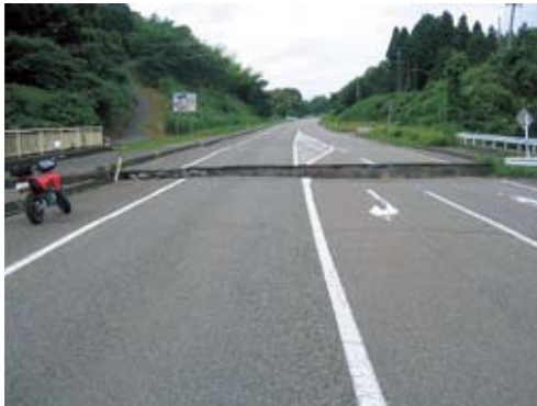
写真2-2-11 路面段差(田沢川橋)
