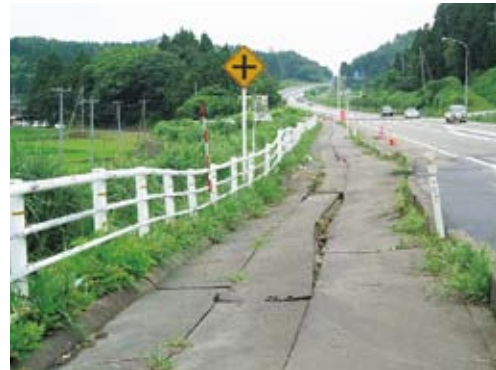
写真2-2-12 歩道沈下(柏崎市西山町別山)
