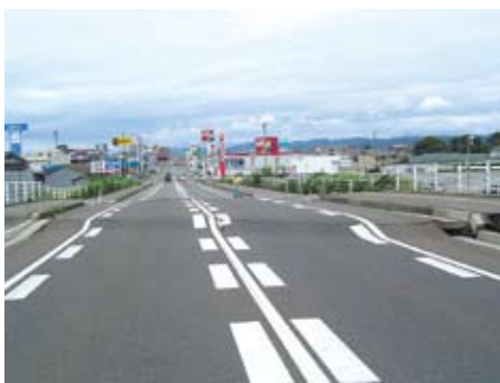
写真2-2-6 路面段差(比角跨線橋)
