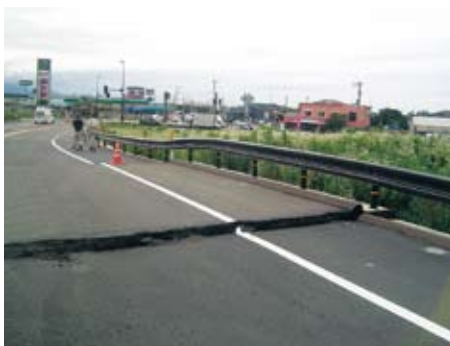
写真2-2-5 路面段差(豊田橋)
