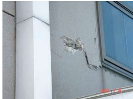
写真2-3-2 展望台 (外壁の一部損傷)
