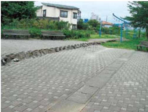
写真2-3-13 大久保緑道(水道橋公園) (インターロッキング舗装の破損)
