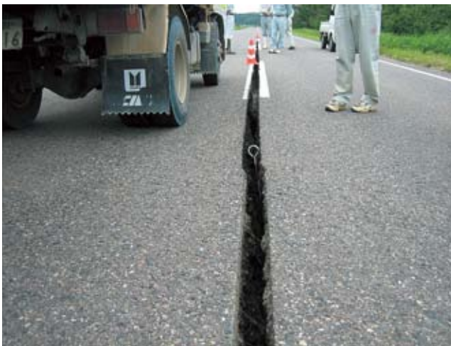
写真2-1-3 地震直後の亀裂の状況(亀裂の深さ100cm以上)
