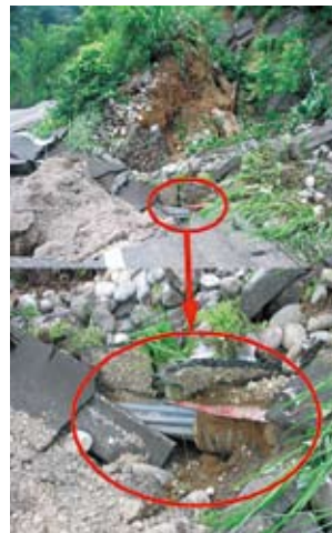
写真2-5-10 地表面に露出した埋設配管(矢印円内が拡大部分)
