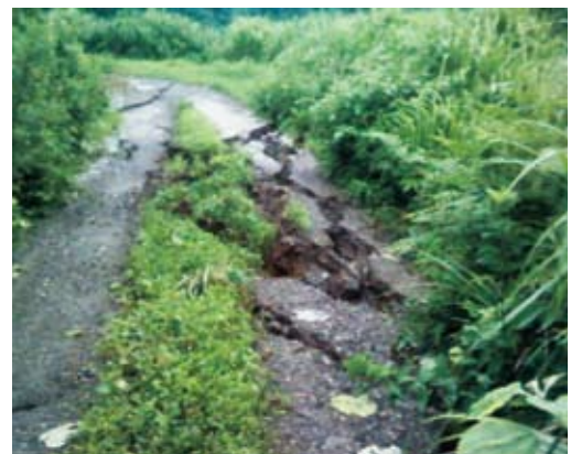
写真2-5-1 薬師岳雨雪量レーダ観測所出雲崎ルート路面亀裂
