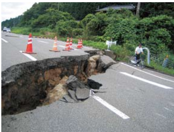
写真2-2-3 舗装亀裂・段差(国道116号柏崎市西山町尾野内)
