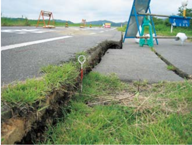
写真2-1-1 地震直後、堤防坂路の取付け部に生じた段差
