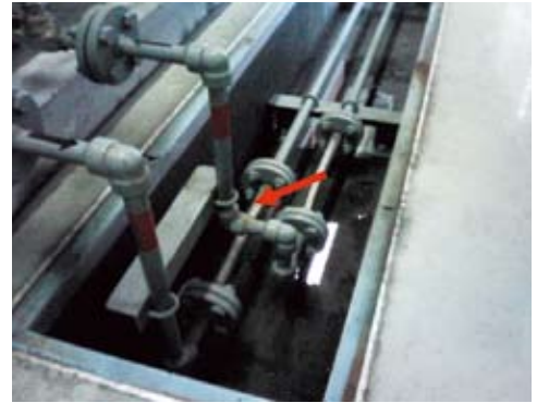
写真2-5-4 発電発電装置 給油管より漏油(矢印部分、ピット内で光って見えるのは漏れた油)
