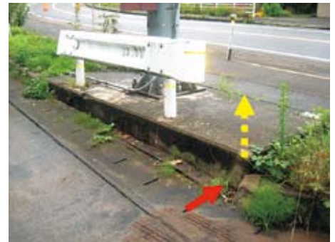
写真2-5-14 国道8号「曾地」道路情報板被災状況(基礎部分が浮き上がり支柱が傾斜した)
