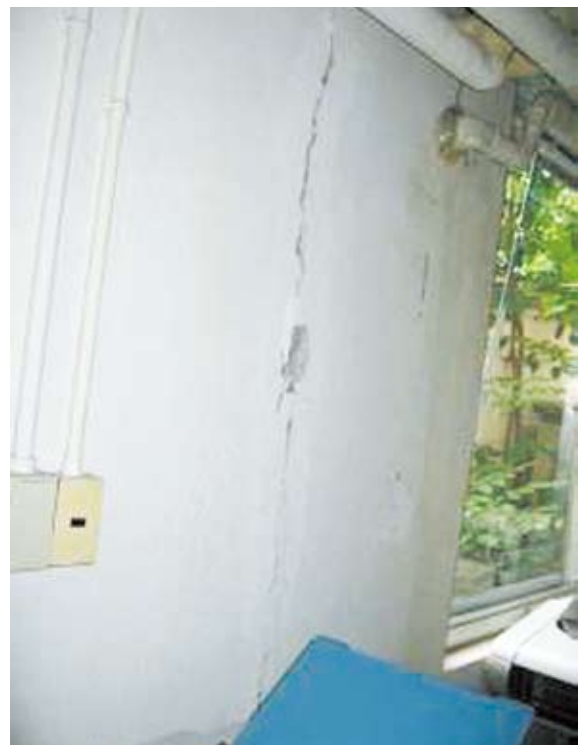
写真2-4-4 内壁のひび割れ
