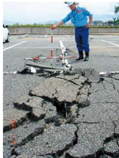
写真2-3-10 鯖石川改修記念公園 (駐車場舗装のクラック)
