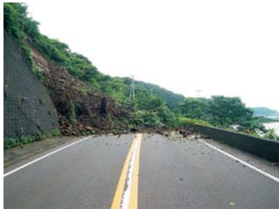
写真2-2-2 法面崩落(国道8号上越市長浜)
