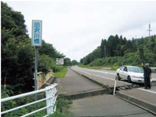
写真2-2-31 被災状況(田沢川橋)
