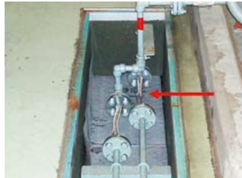
写真2-5-6 発電発電装置 本復旧が完了した発電機給油管の可とう部
