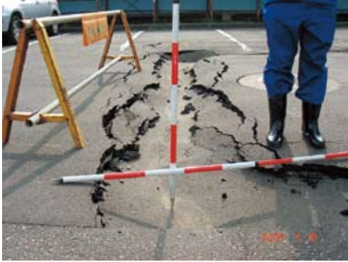
写真2-3-11 駅前公園 (舗装沈下)
