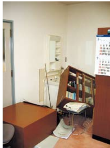
写真2-6-4 信濃川河川事務所所長室書庫の転倒状況
