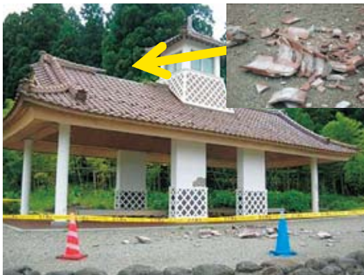
写真2-3-1 地の陣 (四阿の瓦落下)
