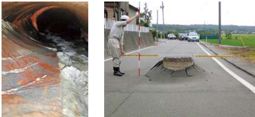
写真2-3-18 下水道管渠の被災状況(左: 柏崎市北園町、右: 柏崎市長崎新田)
