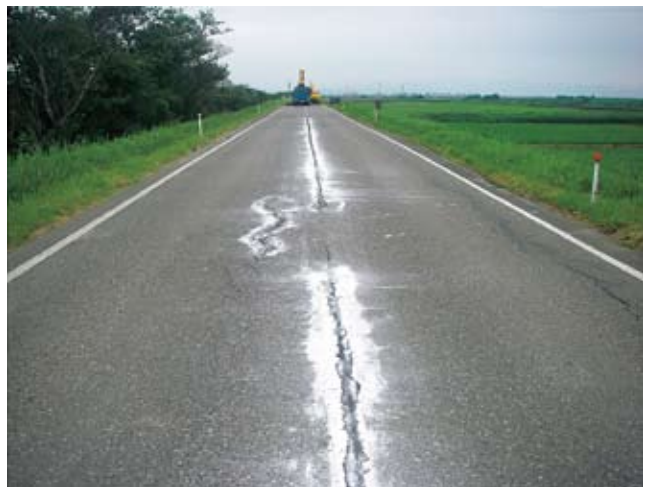
写真2-1-4 地震直後の堤防上面の亀裂
