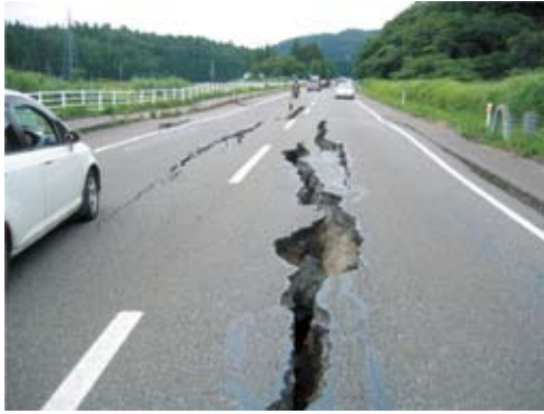
写真2-2-9 路面亀裂(柏崎市西山町坂田)
