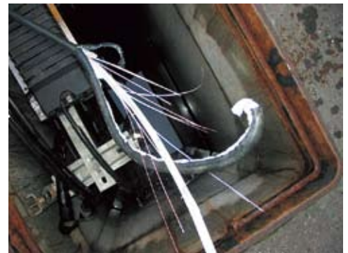
写真2-5-11 破断した光ファイバケーブル(DSF80c)
