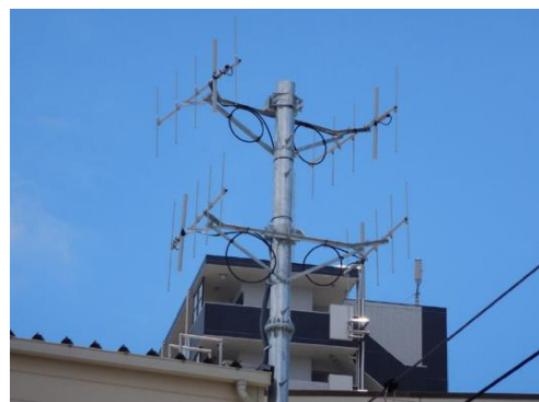
<地上基地局 アンテナ>
