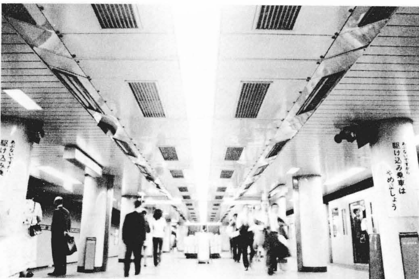
図9 ファンコイルユニット方式によるホーム冷房 ホーム用として特別に設計されたもので、ケーシング下面がそのまま天井になる。またエアフィルタ取替が容易にできる。
