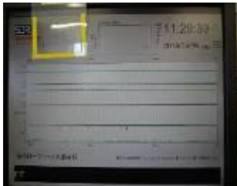
【デジタル地震監視システム】
