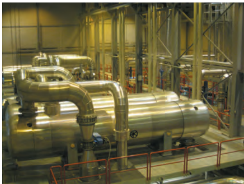
写真6 ネシャヴェトリル (Nesjavellir) 地熱発電所では地熱発電を行うと共に、温水を市街地に供給している。国内の電力のうち2割が地熱、残り8割が水力によって得られている。
