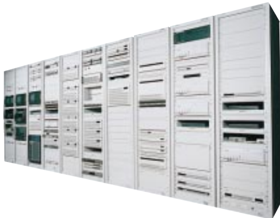
地上デジタル放送送出システム Digital terrestrial television broadcasting studio system
