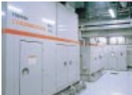
コジェネレーションシステム Cogeneration system
