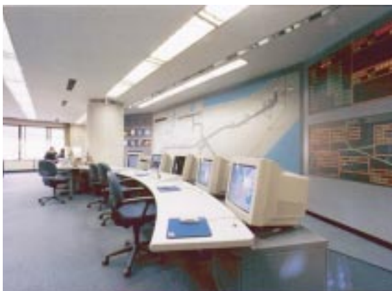
交通管制室 Traffic control room
