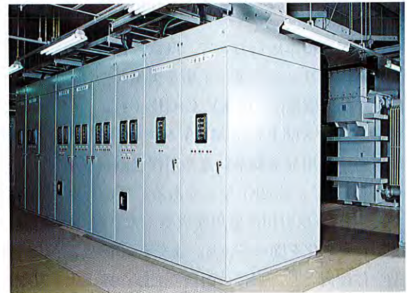
22 kV 受変電設備 22 kV substation
