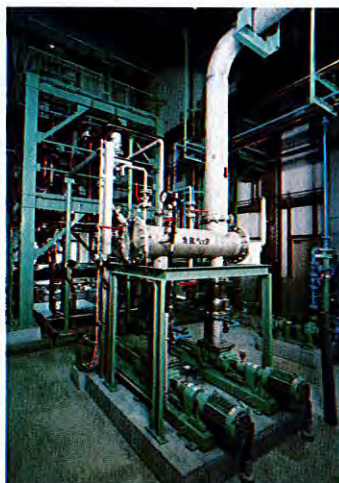
遠心薄膜乾燥機を用いた汚泥処理設備 Centrifugal sludge dryer for sewage treatment plants
