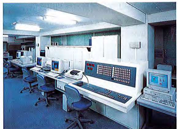
大気情報管理室 Air pollution monitoring room
