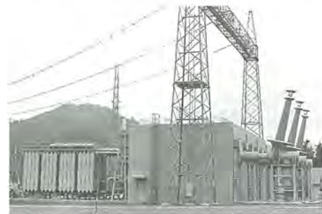
(b) 500/190kV, 750MVA 単巻変圧器
