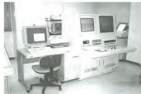
(a) 設備診断エキスパートシステム操作卓
