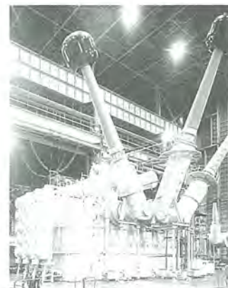
525(275)/19.5kV, 1,050MVA 主変圧器
