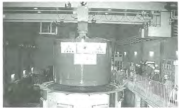
水力発電プラント
