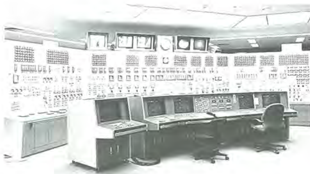
中部電力(株)碧南火力発電所3号機中央制御室
