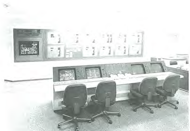
メインコントロールセンター
