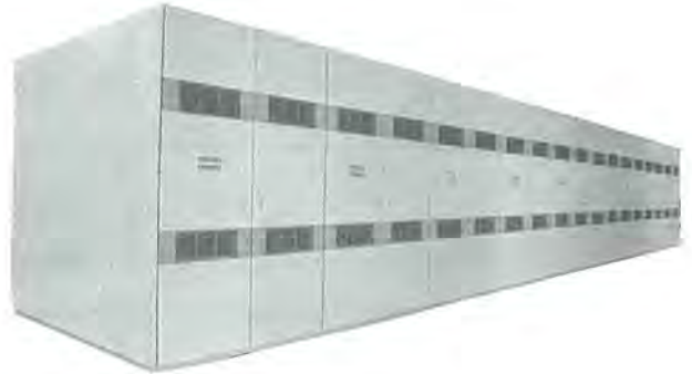
山梨新実験線 電力交換システムインバータ装置
