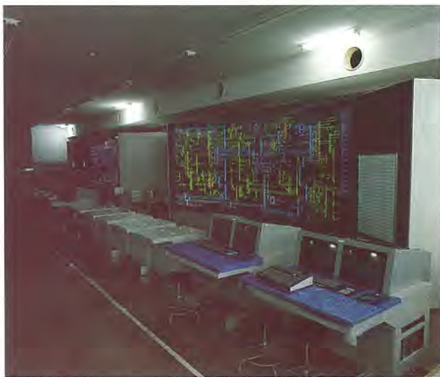
運転操作訓練シミュレータ
