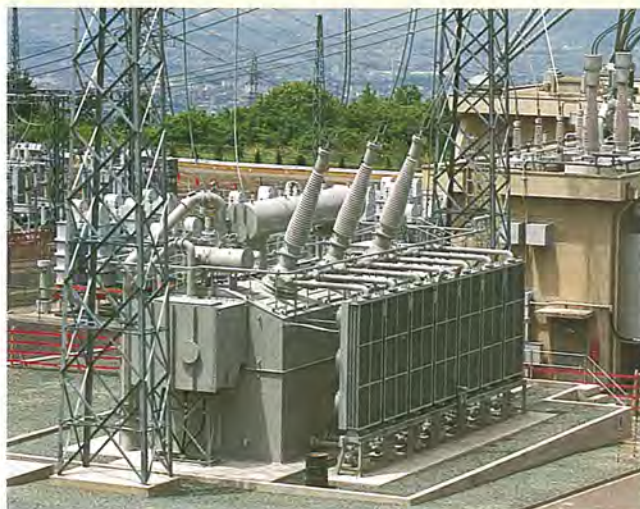
275kV、250MVA分路リアクトルー体形変圧器
