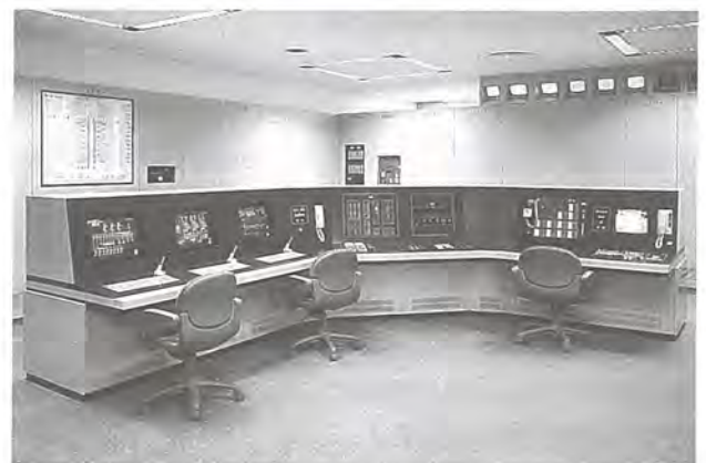
防災センター内中央監視卓
