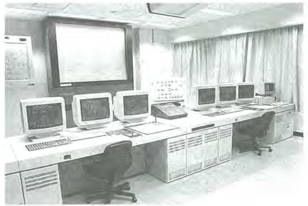
配電線自動制御システム操作卓
