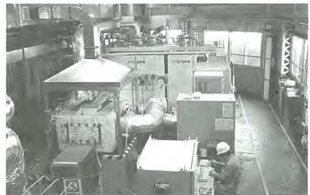
10 kW 間接内部改質電池の試験風景
