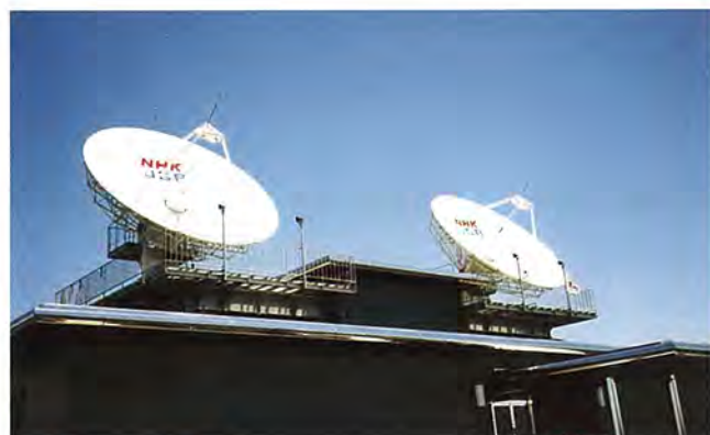
7mφアンテナ装置
