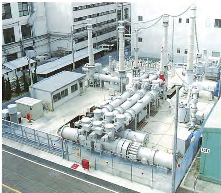
新形550kV GIS長期課・通電試験状況
