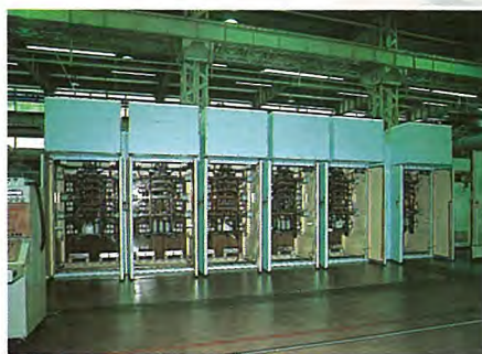
サイクロコンバータ変換装置
