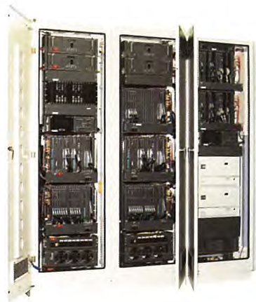
原子炉制御装置
