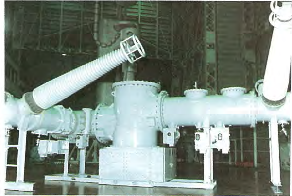
300kV全三相一括形GIS(耐電圧試験形態)
