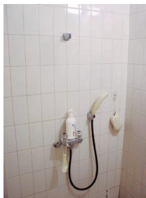
シャワー室 (110cm×170cm) (ガスの元栓は保健室湯沸かし器と共通のため、保健室内流しの横にある)
