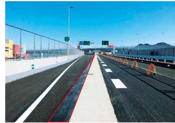
写真3-4-9 Bライン:埋設ジョイント
