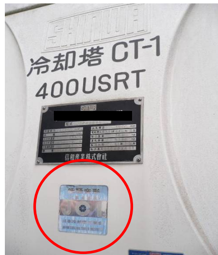
図9 冷却塔に貼付された騒音ラベルの例
