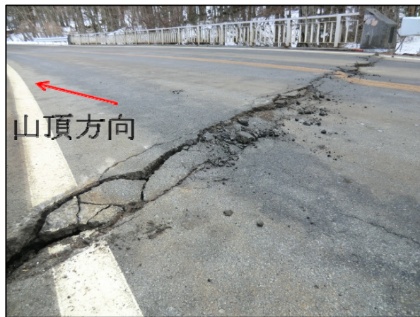
写真 5-10 富士スバルライン 露の澤橋に生じた段差（最大約 10 cm）
