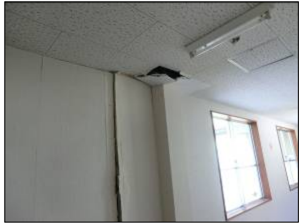
写真 5 - 8 公民館の内壁及び天井剥離 （十日町市上山）
