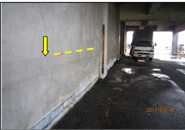
写真 5-2 津波の痕跡 （釧路市釧路東港区副港、表 1 の 4）
