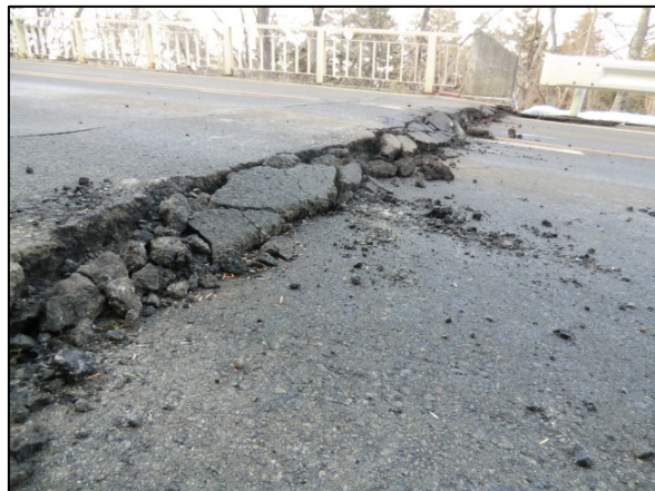
写真 5-12 富士スバルライン 丸山橋に生じた段差（最大約 30cm）
