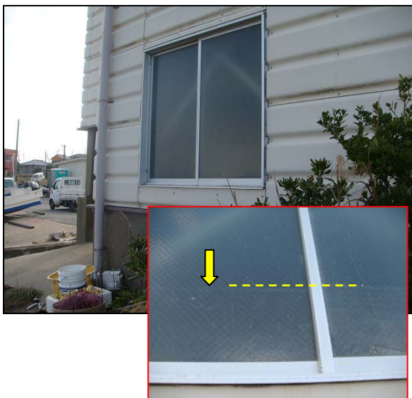
写真 5-23 津波の痕跡 (鉾子市黒生漁港、表 3 の 56)
