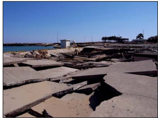
写真 5-41 相馬市 相馬験潮所付近の 損壊した岸壁 (図 5-12⑪ : 3月 28日撮影)
