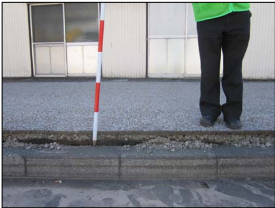
写真 5 - 3 富士宮市役所北側道路の沈降 （富士宮市弓沢町）
