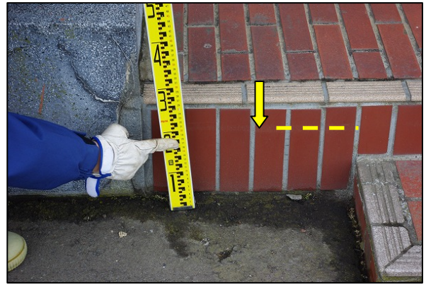
写真 5-7 津波の痕跡 （室蘭市追直漁港、表 1 の 15）
