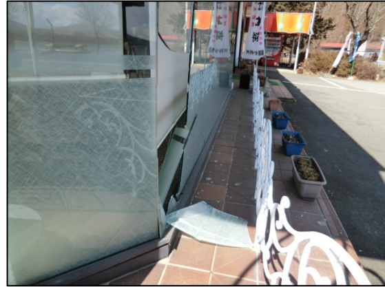
写真 5-8 破損した店舗のガラス（山中湖村山中）
