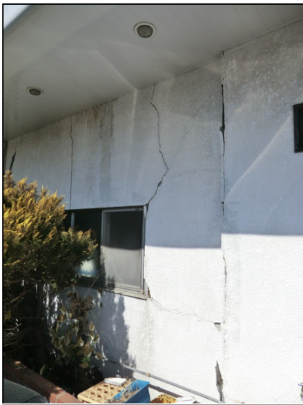
写真 5-9 亀裂の入った店舗の外壁 （山中湖村山中）
