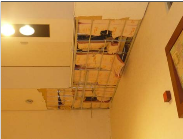
写真 5 - 7 多目的ホール天井の破損、落下 （十日町市上山）
