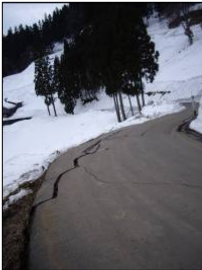
写真 5—19 道路の亀裂 （十日町市松之山赤倉）
