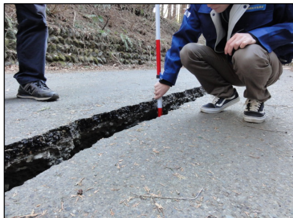
写真 5 - 6 林道の亀裂（富士宮市栗倉） 幅約 10cm の亀裂が生じ、谷側が約 10cm 沈降
