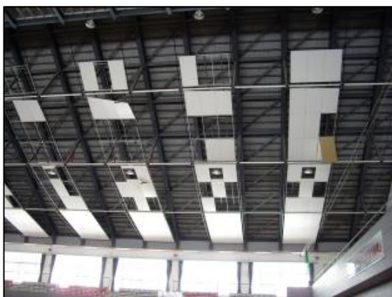
写真 5—16 松代総合体育館の天井パネルの 落下（十日町市松代）
