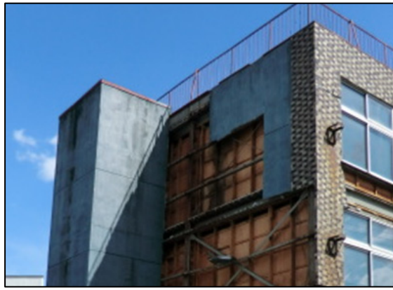
写真 5 - 4 ビル壁面の損壊 （富士宮市貴船町）
