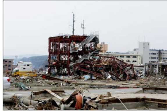
写真 5-35 南三陸町 防災対策庁舎 (図 5-10⑦) : 4 月 11 日撮影
