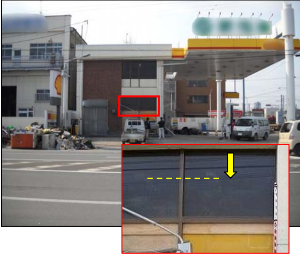
写真 5-9 津波の痕跡 （八戸市新湊、表 2 の 21）
