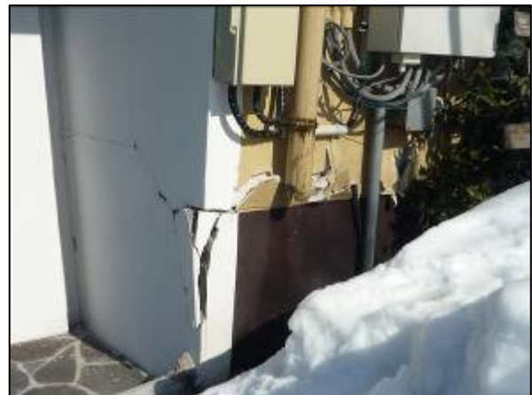
写真 5 - 10 住家外壁の亀裂、剥離 （十日町市上山）
