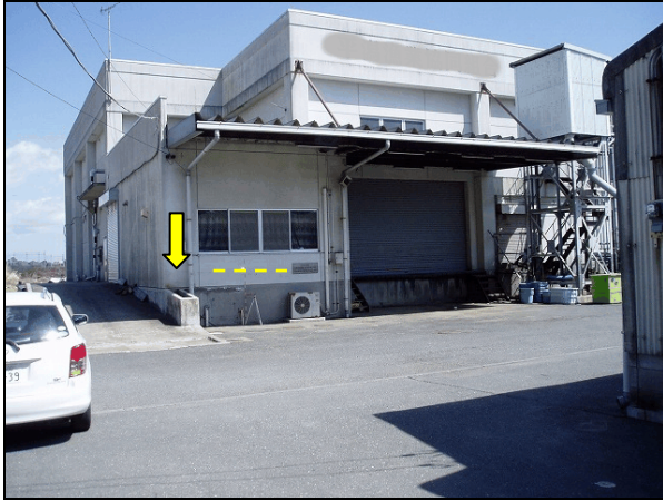
写真 5-20 津波の痕跡 (北茨城市平潟漁港、表 3 の 46)
