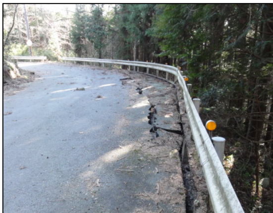
写真 5 - 5 林道の損壊（富士宮市栗倉） 幅約 20cm の亀裂が生じ、谷側が 20cm 沈降
