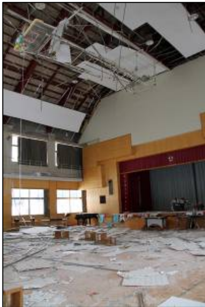
写真 5-11 小学校 天井パネル 落下 （津南町上郷：津南町提供）
