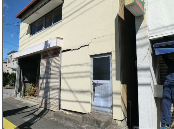
写真 5 - 2 住家壁面の亀裂 （富士宮市弓沢町）
