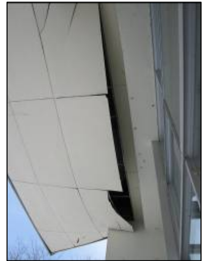
写真 5—17 松代中学校体育館のひさし部分の剥離 （十日町市松代）
