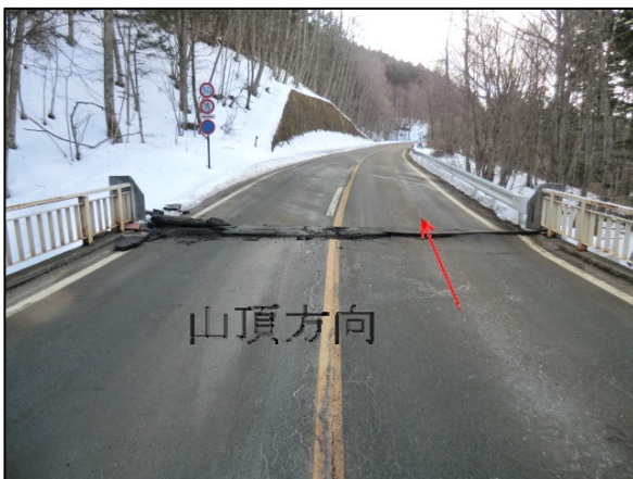
写真 5-11 富士スバルライン 鷹の平橋に生じた段差（最大約 10cm）
