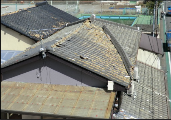
写真 5 - 1 屋根瓦の損壊（富士宮市弓沢町）
