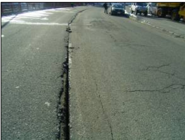
写真 5—5 国道 117 号線の地割れ（栄村北信）
