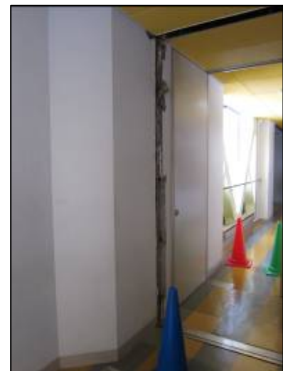
写真 5—18 松代中学校体育館の内壁の亀裂 （十日町市松代）
