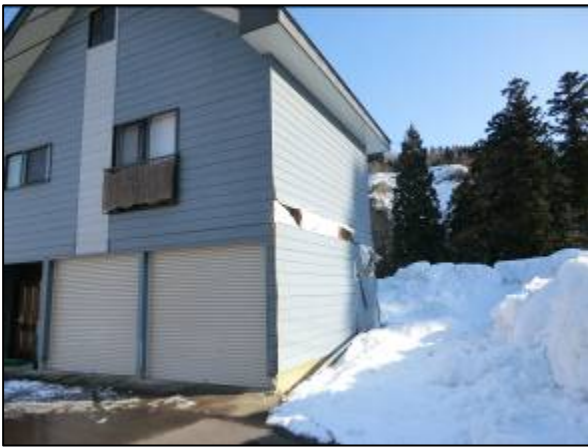
写真 5—3 住家外壁の剥離（栄村北信）
