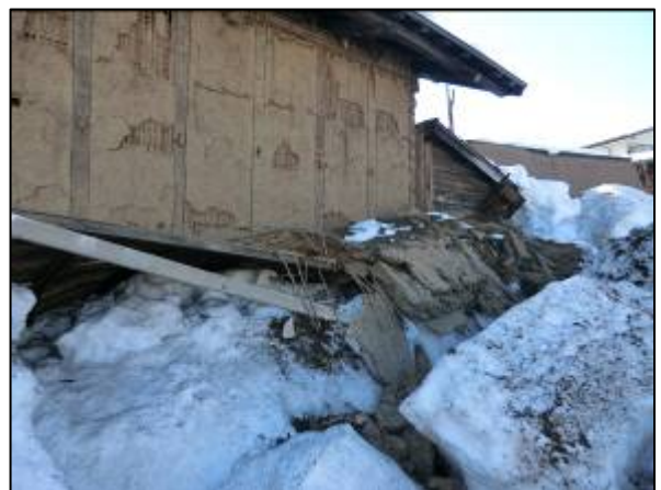
写真 5—4 土蔵の外壁剥離及び倒壊 （栄村北信）
