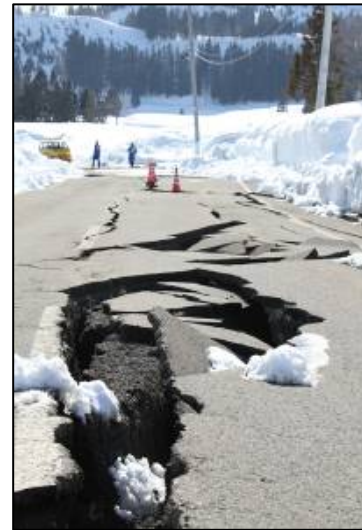
写真 5—15 道路の地割れ（津南町上野：津南町提供）
