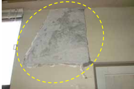
奥州市衣川総合支所庁舎1階内壁面の一部剥離。
