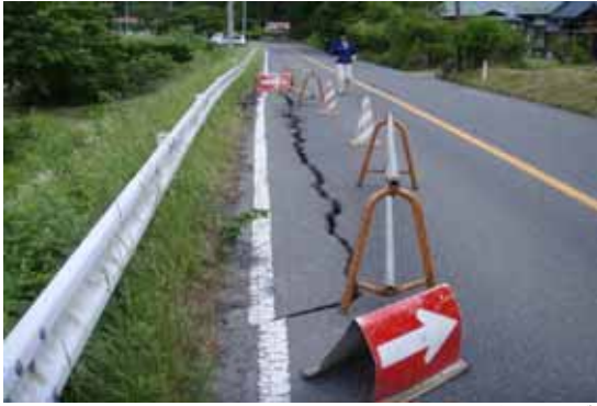
国道398号線の亀裂。長さ約10mにわたり路側帯が外側にずり落ちている。
