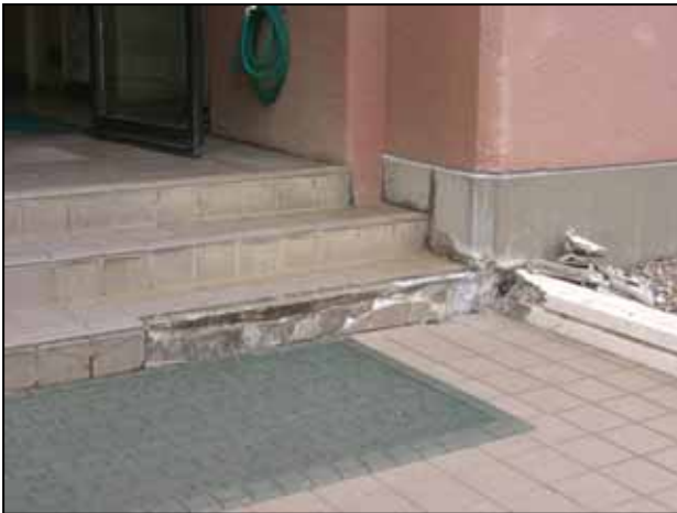
南東側通用口の階段部分（玄関の両側）に破損が見られる
