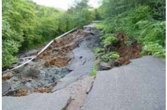
市道馬場駒の湯線の路面崩壊。
