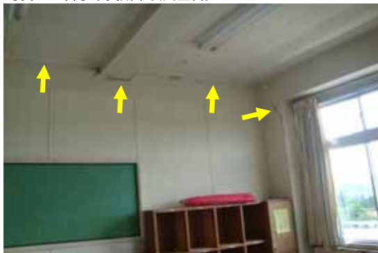
衣川中学校3階教室の天井隅と柱に無数の亀裂。亀裂の向こう側に接して建て増しされた校舎がある。
