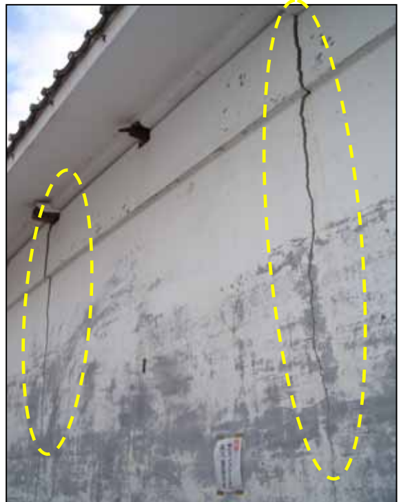
土蔵外壁の亀裂
