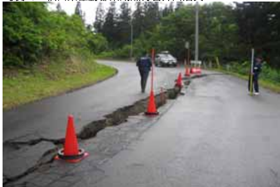
国道397号線路面に約25mの亀裂が生じ、谷側が約30cm沈降している（撮影方向北から南）。
