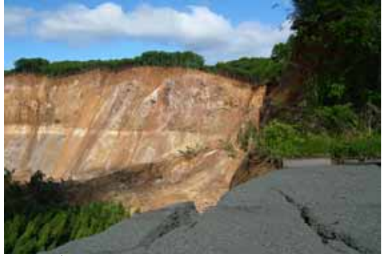
荒砥沢ダム周辺の大規模崩壊。
