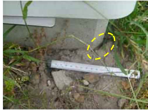
震度計基礎台西側と地面との隙間。
