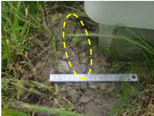
震度計基礎台の周囲と東西両側の地面に明瞭に亀裂がある（写真は基礎東側）。
