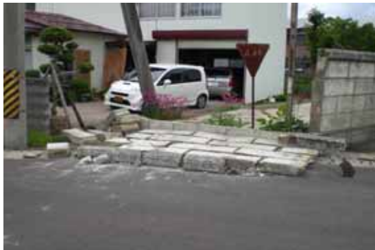
工場のブロック塀の一部損壊。
