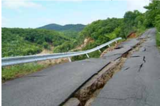
市道馬場駒の湯線の路面崩壊。
