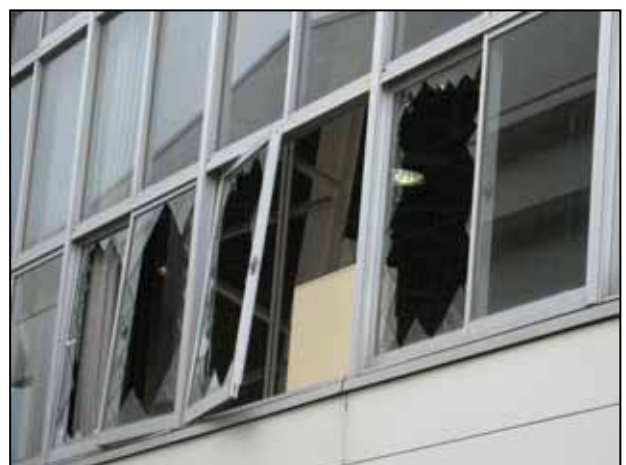
窓ガラス破損及び窓枠落下
