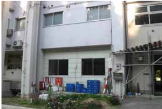
震度計が設置されている湯沢市皆瀬支所。壁や窓に被害は無い。青いプラスチックケースと赤白ボールは落下したり転倒はしなかった。
