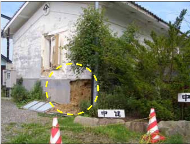
土蔵外壁等の崩れ、ほかに亀裂が複数見られる
