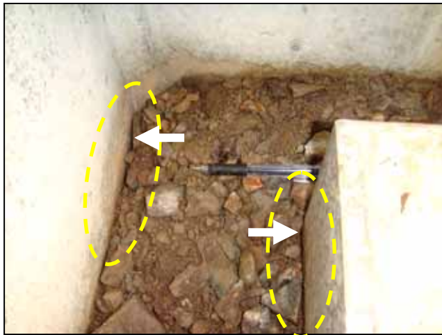
台座 - 土砂、土砂 - 囲いの間に僅かな隙間が認められる
