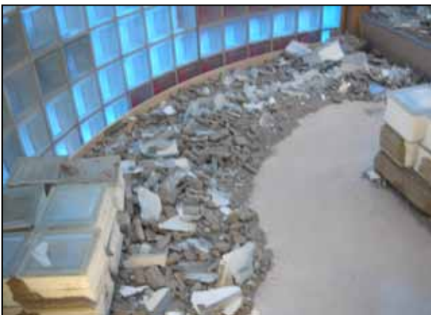
建物の内側、崩れたガラスブロックが散乱している
