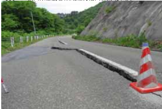
国道342号線路面に約15mの亀裂が生じ谷側が沈降している。
