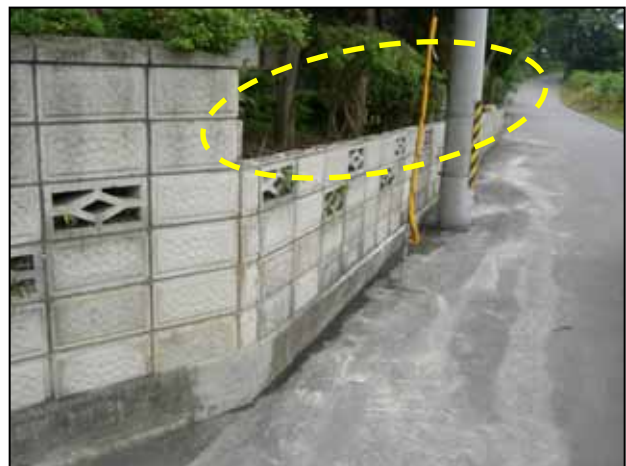
ブロック塀の上 2 段が崩れた
