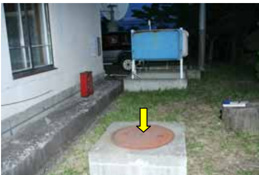
震度計(岩手県整備)から南東方向を見る
