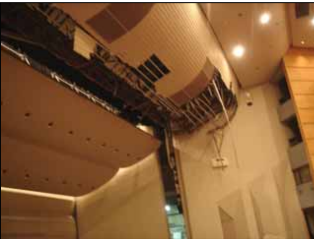
大ホールのステージの天井にあった音響板が落下
