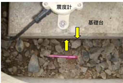
基礎台と周りの地面にわずかな隙間
