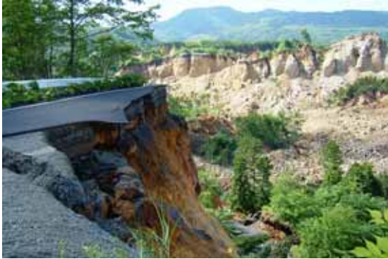
荒砥沢ダム周辺の大規模崩壊。
