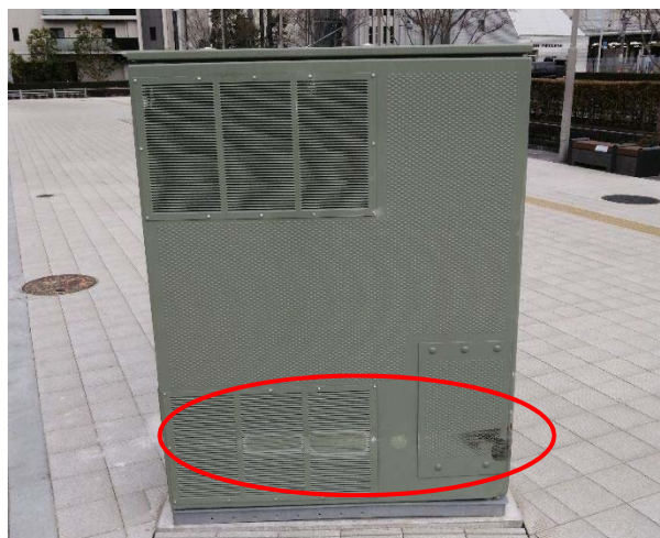
図 3 地上変圧器の損傷
