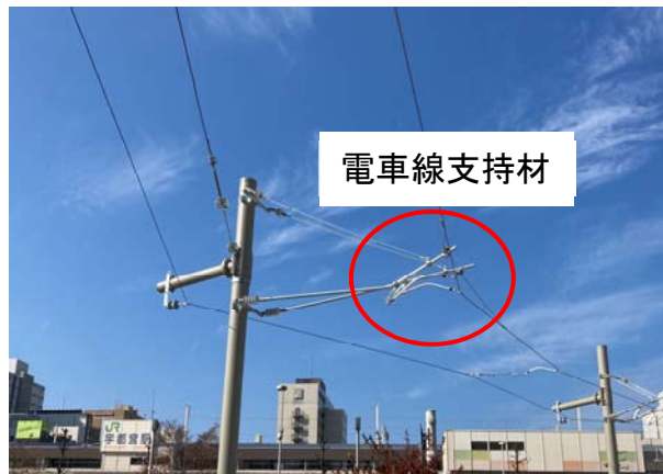
図 5 電車線支持材の損傷
