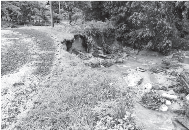
▲昨年8月13日の大雨で崩落した里道の様子
