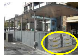
駅出入口の止水板
