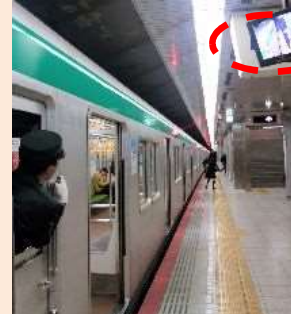
ホーム車掌用モニター設備の増設
