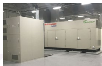
非常用発電機
