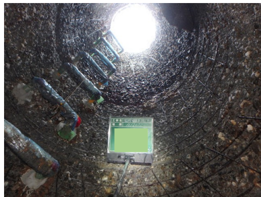
Fig. 1 腐食したマンホール（底部から撮影）
