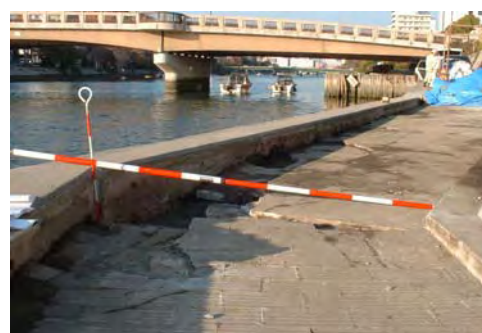
空洞化による天端の陥没(市内派川)
