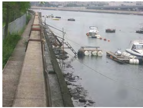
昇降梯子による河川護岸の損傷(元安川)
