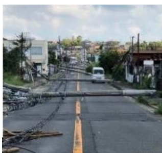
<電柱の倒壊による道路閉塞の事例>
