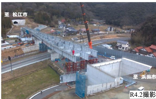
【写真③】静間・仁摩道路 大国高架橋(仮称)付近の施工状況
