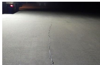
エプロン舗装表面に発生した 経年劣化によるひび割れ
