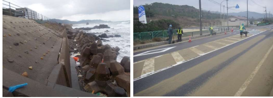
写真1 海岸浸食に伴う、転倒の恐れのある擁壁 写真2 冬の飛砂及び滞砂
