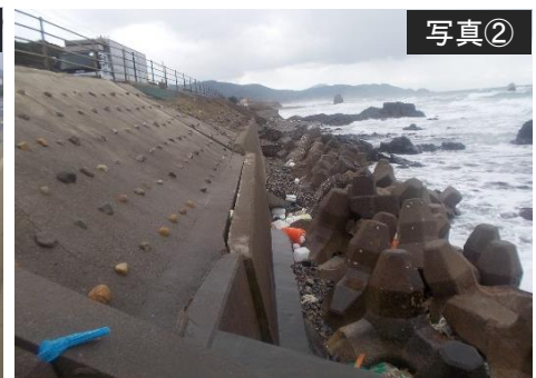
海岸浸食に伴う、転倒の恐れのある擁壁 延長L=約160m 防災点検要対策箇所 ⇒変状発生時は通行止措置必要
