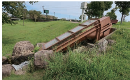
園内に設置された小水力発電施設
