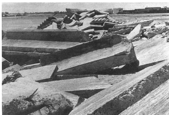
(a) 決壊した四日市磯津海岸の堤防
