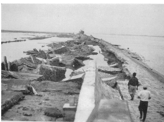
(d) 半田武豊海岸堤防の被災
