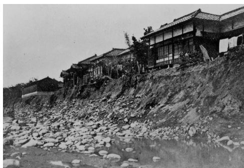
写真2-11 桐生新川橋上左岸浸食状況 (渡良瀬川河川事務所、「カスリーン災害記録集」)
