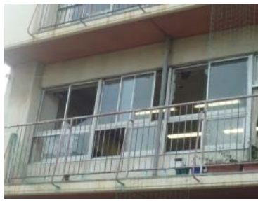
小学校の被害の様子
