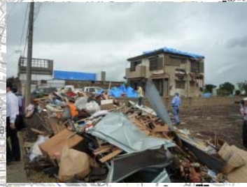
住宅被害及び撤去した瓦礫の様子
