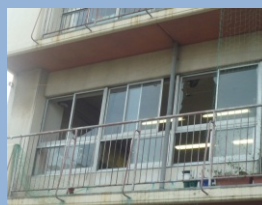
小学校の被害の様子
