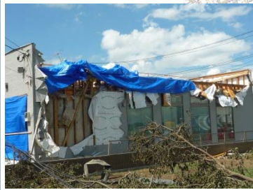
住宅街の被害の様子
