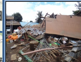
住宅被害の様子
