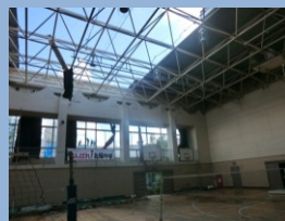
中学校体育館の 被害の様子
