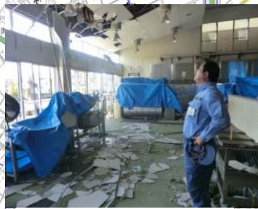
給食センターの被害の様子
