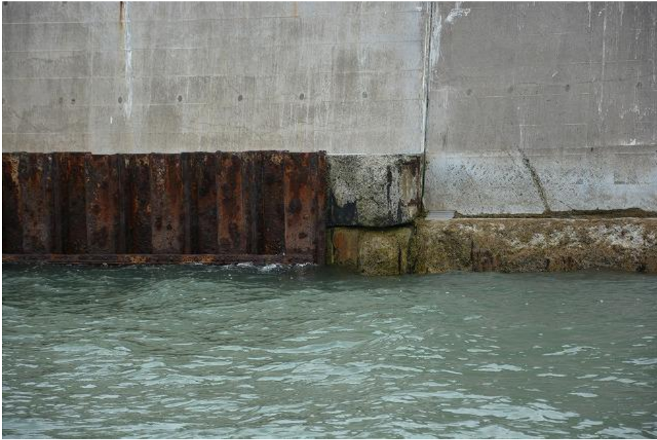
写真4-5-5 三池島、むき出しのコンクリート壁（2015年6月20日）
