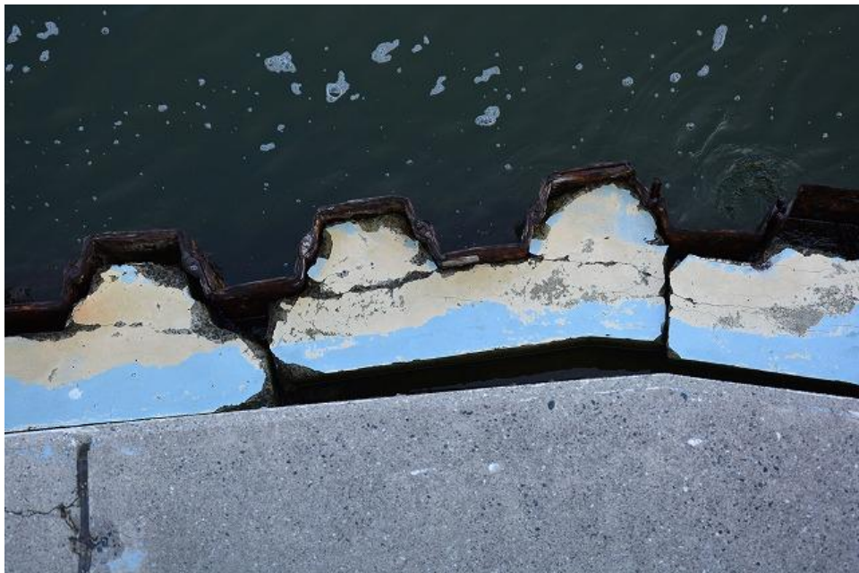
写真 4-5-4 三池島、老朽化で傷んだ外壁 (2015年6月20日)
