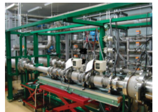
湘南工場に新設された気体流量計の校正設備
