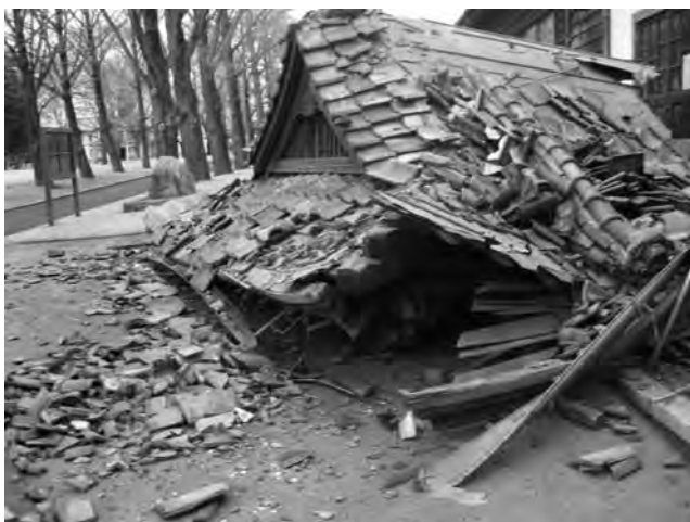
崩落した玄関廂（旧水戸農業高等学校本館）
