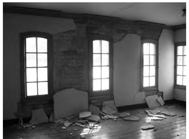
土壁の剥落（旧水海道小学校本館）
