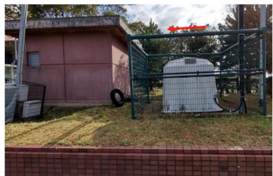
周辺地盤の変形
