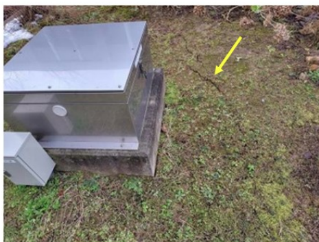
周辺地盤のひび割れ
