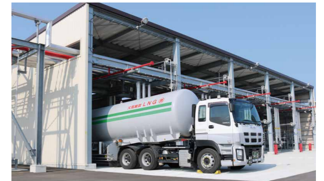
△ LNGローリー出荷設備（相馬LNG基地）
