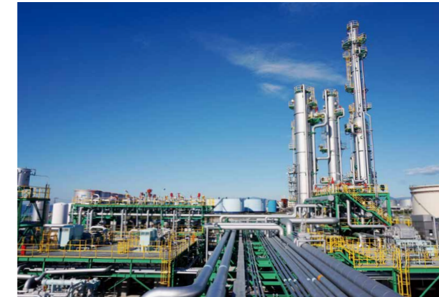
△ 苫小牧 CCS 実証プロジェクト地上設備 写真提供：日本CCS調査（株）
