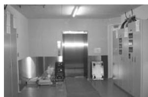
物流用エレベーター
