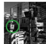
踏切支障報知装置
