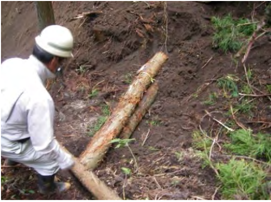
③当該箇所は谷が深いため、桁(基礎丸太)を3本使用し高さを調整した。
