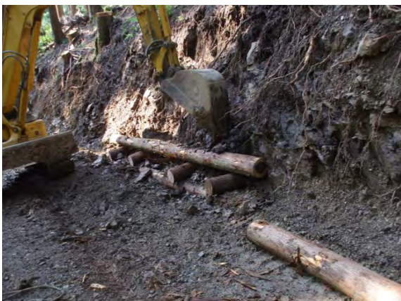
③桁(基礎丸太)と1段目の桁との設置は、3～4分になるように組み、下の横木と釘で止め、横木と桁との間の隙間を土で埋め戻し、2段目の横木を設置する盤をつくる。
