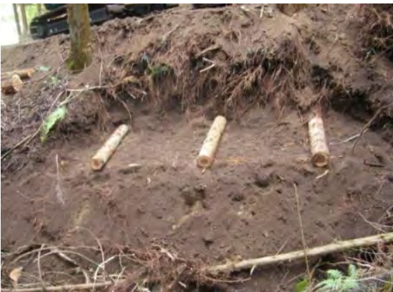
⑤桁に横木を約1m間隔で組んで留める。横木は水平に置き釘で止める。
