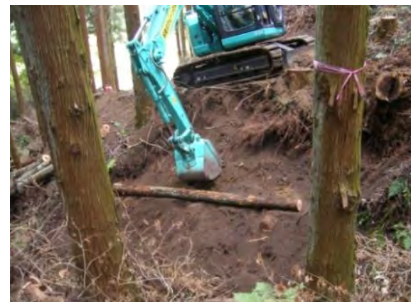
⑧最上部の桁を止めたら、埋め戻し・転圧をしっかりと行い、盛土法面もしっかり転圧する。
