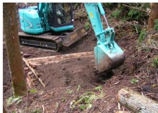
⑩埋め戻し、路盤を仕上げる。下流部は豪雨の際、流水が路盤に流れ込まないように約50cmほど高く仕上げる。
