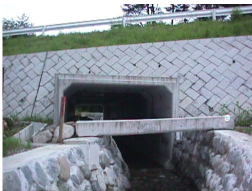
写真－事例 18－5 動物の通路（内部左側）を確保したボックスカルバート
