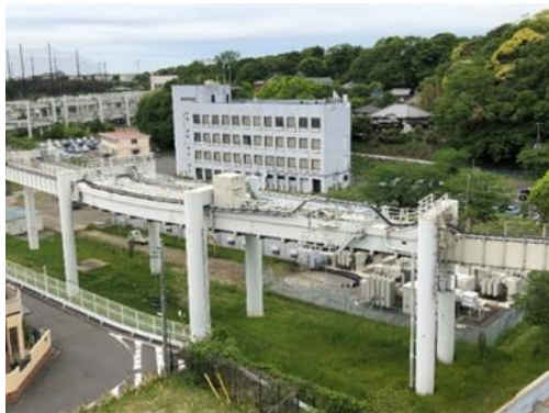
図 4-6 殿台変電所全景
