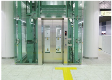
エレベーター
