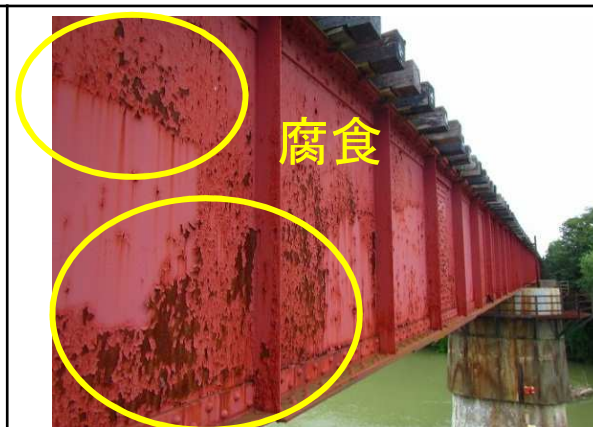
腐食が発生した橋りょう
