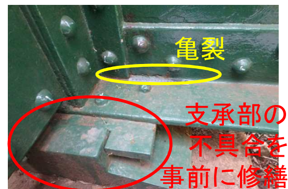
亀裂が発生した橋りょう
