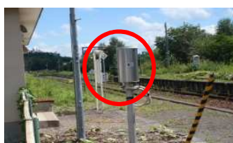
雨量計の増設
