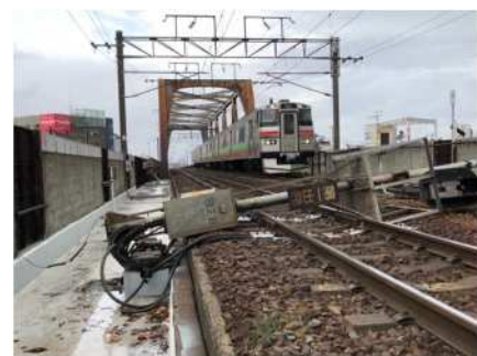
倒壊した「下り第1出発信号機柱」
