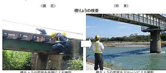
橋りょうの変状を目視により確認
