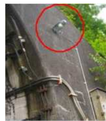
トンネル出入口の照明
