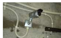
陸底部斜坑のカメラと放送設備
