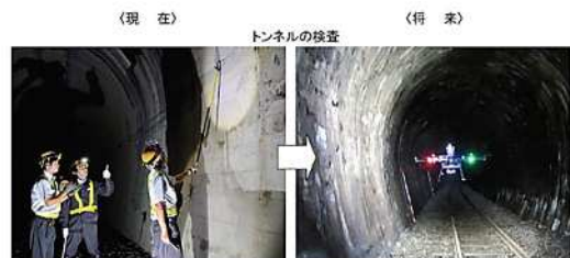
トンネル壁面の変状を目視により確認
