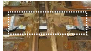
可動ノーズ先端部のポイントヒーター
