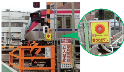
踏切支障報知装置(非常ボタン)
