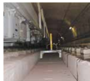
▲限界支障検知器
