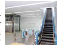
▲エレベーター・エスカレーター(日暮里駅)
