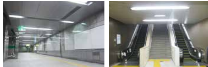
▲照明のLED化 ▲エスカレーターの改修・更新による省エネ化
