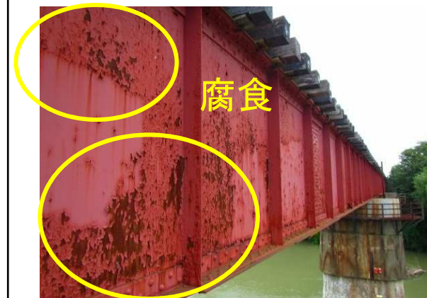
腐食が発生した橋りょう
