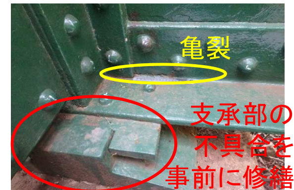
亀裂が発生した橋りょう
