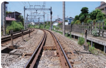
脱線防止ガードレール
