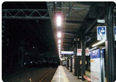
平沼橋駅ホームのLED照明
