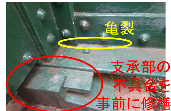
亀裂が発生した橋りょう
