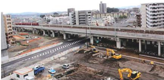
〈高架化後〉 日豊本線高架開業後 鉄道残存敷のレールは全て撤去
