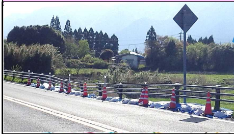
国道57号 阿蘇市永草 路面沈下、擁壁倒壊
