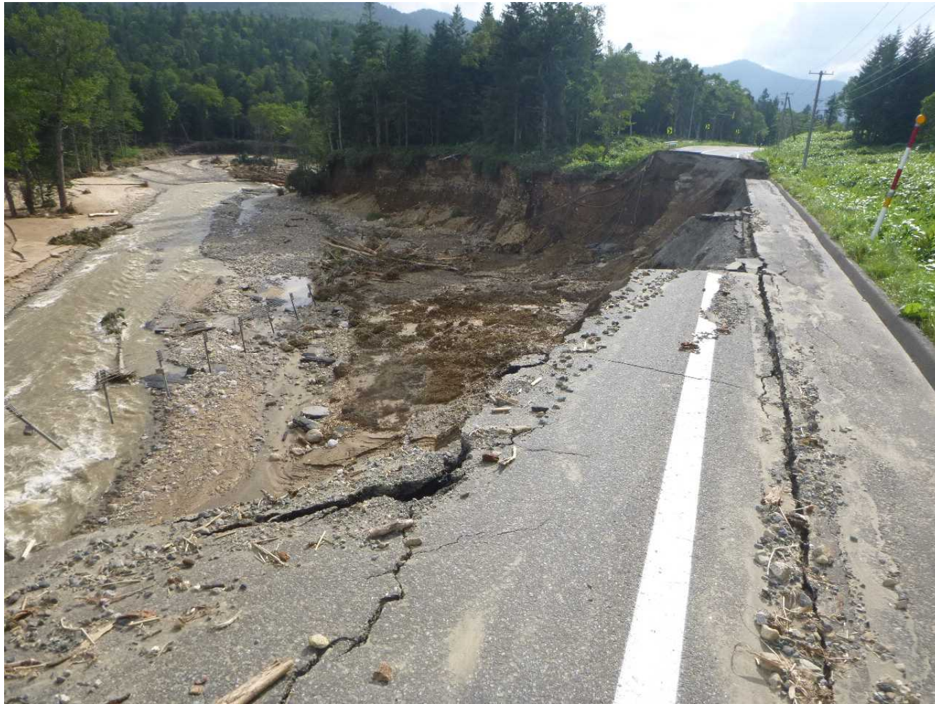
国道274号 日高町 日勝峠7合目付近 (H28.9.3の状況)
